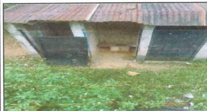
Foto 3: MANTENIMIENTO A BAÑOS EN MAL ESTADO
